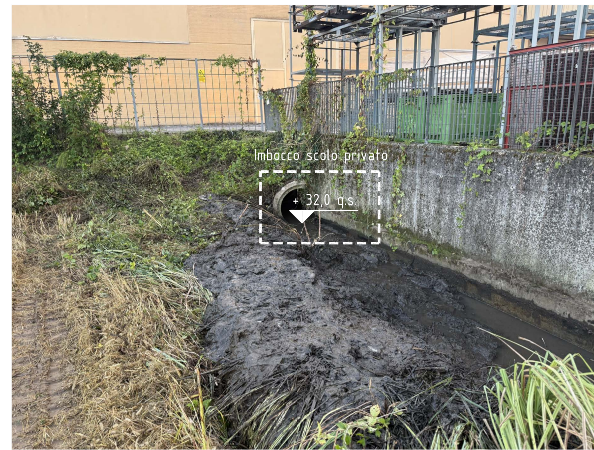
VISTA 2 Innesco del fossato di scolo nella rete interrata realizzata con tubazione in c.a.v. DN 100
