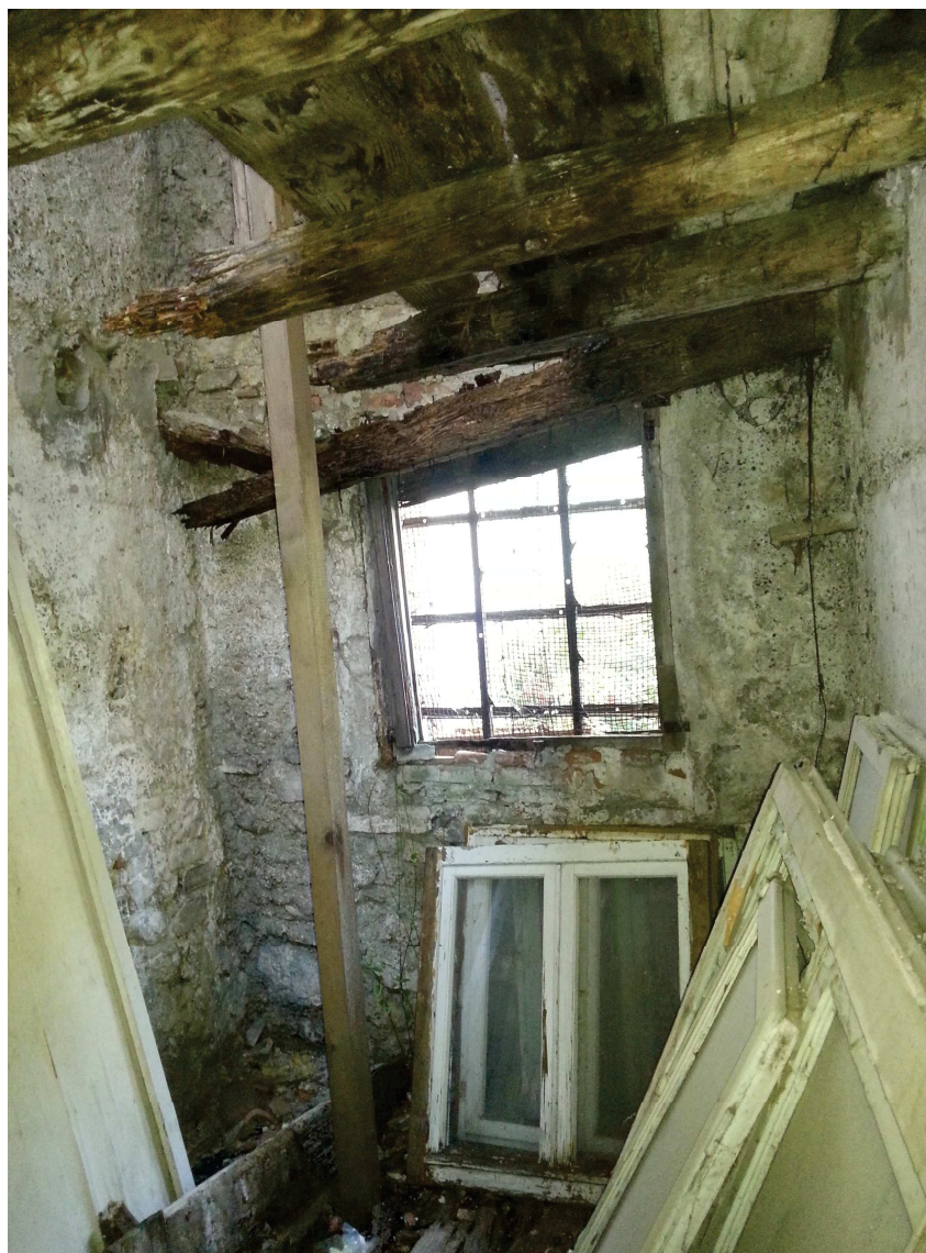
Particolare solaio parzialmente crollato
