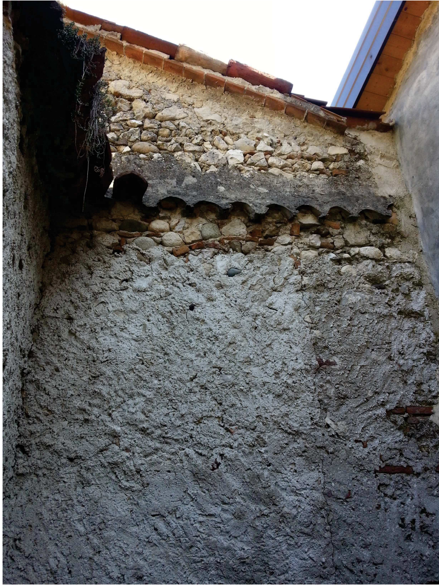
Particolare copertura crollata
