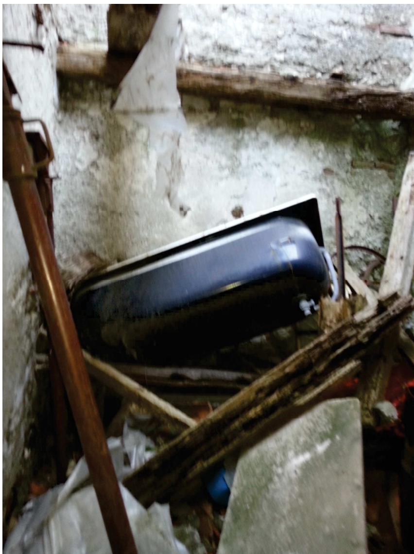
Particolare solaio crollato
