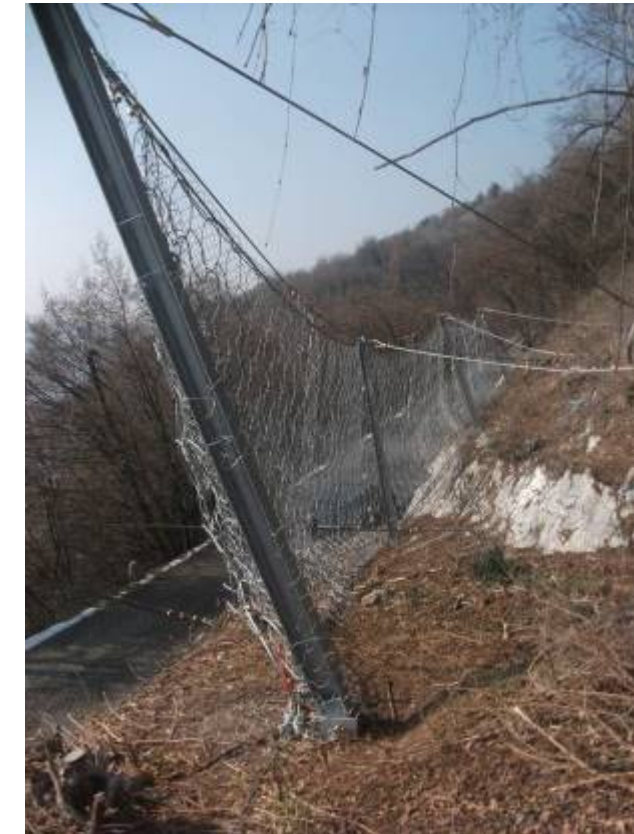
Particolare barriere paramassi
