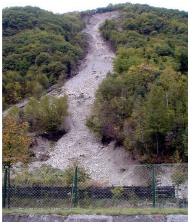
Foto della frana
