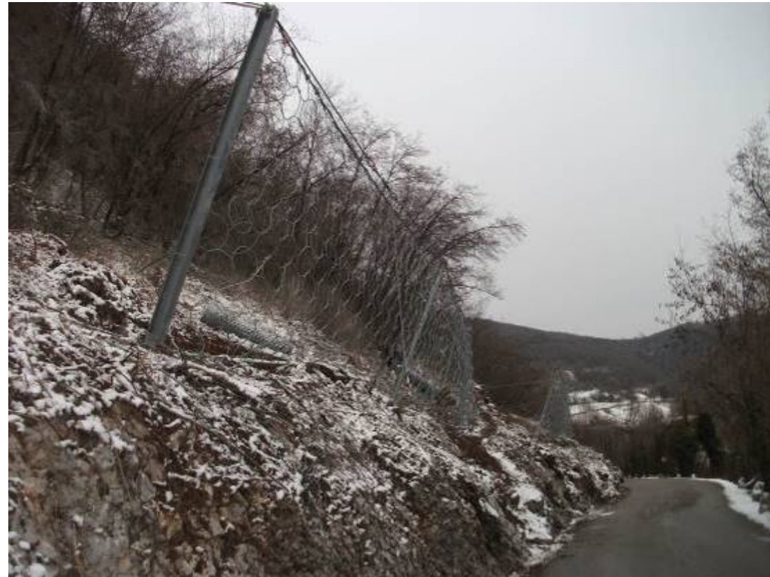
Particolare barriere paramassi
